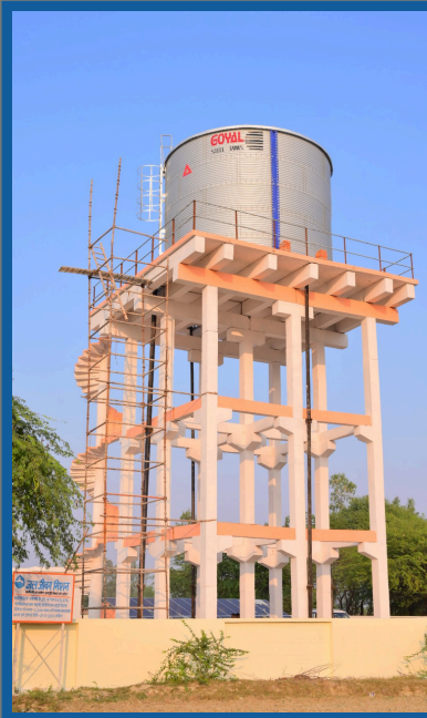
Precast RCC ESR
